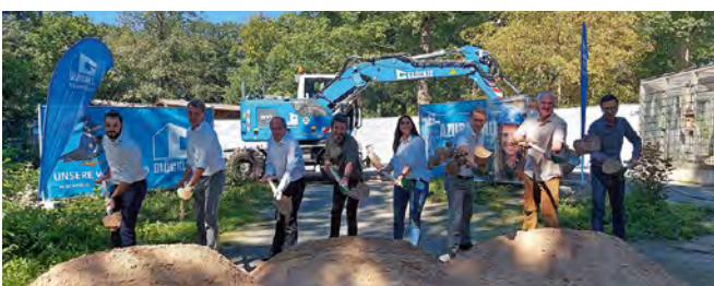
Start des Azubi-Bauprojekts der Firmengruppe Glöckle für ein Vogelhaus im Schweinfurter Wildpark.
